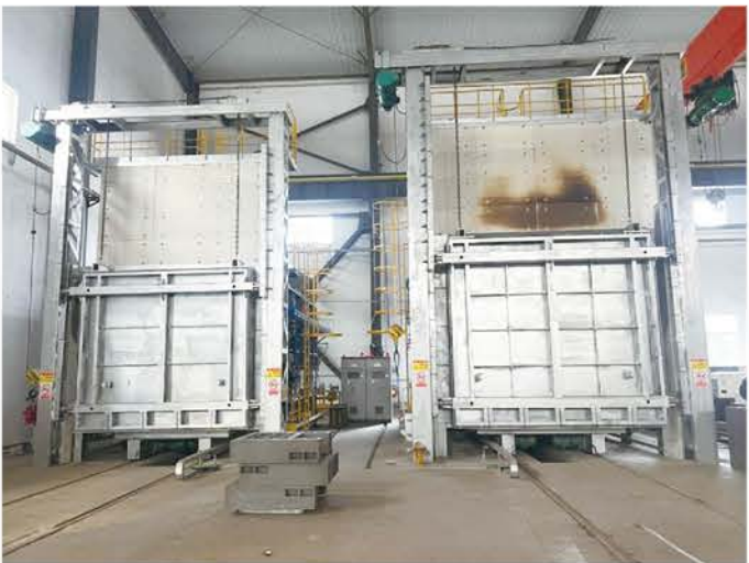
天然气热处理时效炉
